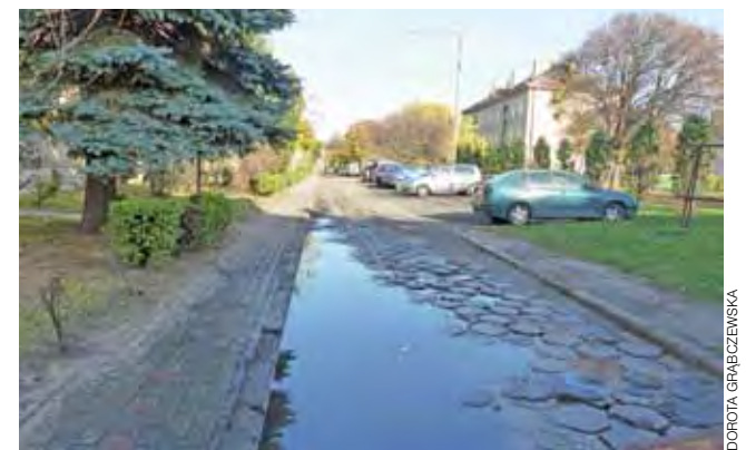
Trylinka na drodze wewnętrznej wzdłuż bloków Narutowicza 85a, b, c jest wypaczona, a po deszczu robią się tam kałuże wody.
