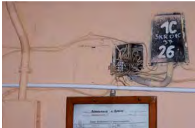
Lokatorzy oczekują, że kable w klatkach schodowych oraz przewierty przez stropy zostaną wreszcie uporządkowane.
