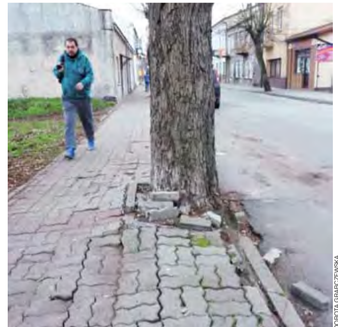
Korzenie drzewa „wysadziły” chodnik przy ul. Narutowicza.
