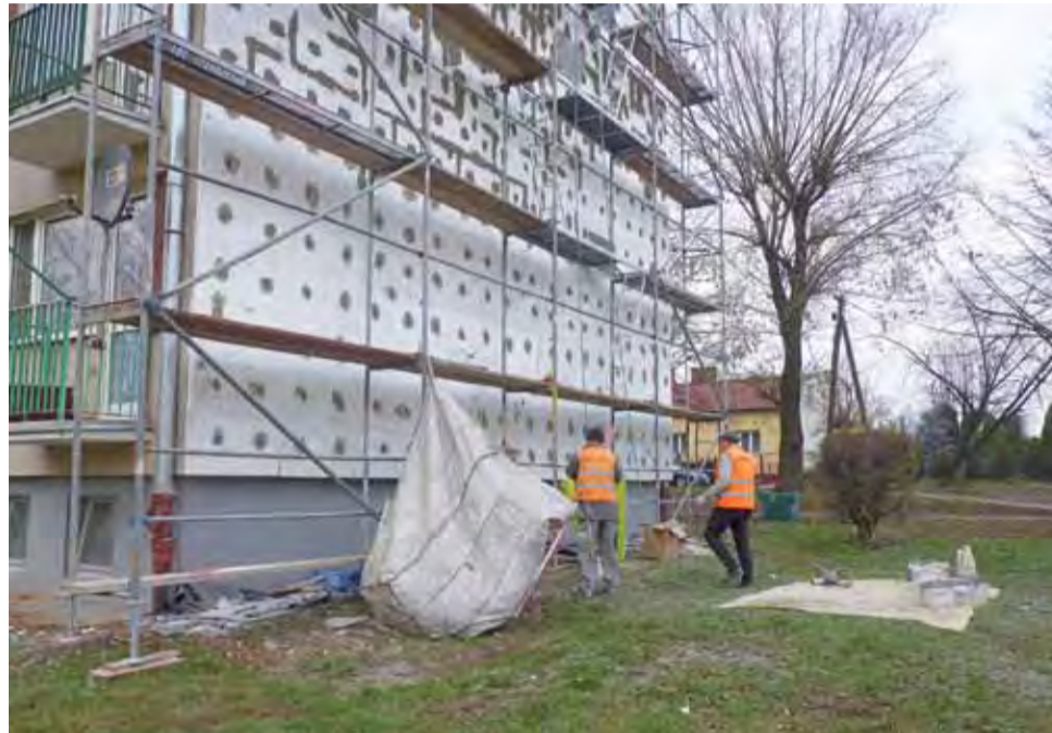
Pracownicy żychlińskiego Budomatu docieplają szczyt bloku przy Traugutta 6. Wcześniej zakończyli docieplanie szczytu bloku Traugutta 8.
