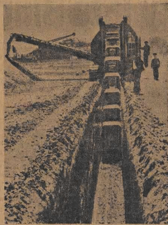
Stosownie do uchwały Rady Ministrów ZSRR — o nowoczesnych sposobach nawadniania obszarów pustynnych — uruchomiono już tysiące maszyn — kąpiących rowy nawadniające (magistrale wodne). Na ilustracji widzimy jedną z nowoczesnych kopców kanałów wykonujących pracę setek rąk ludzkich.
