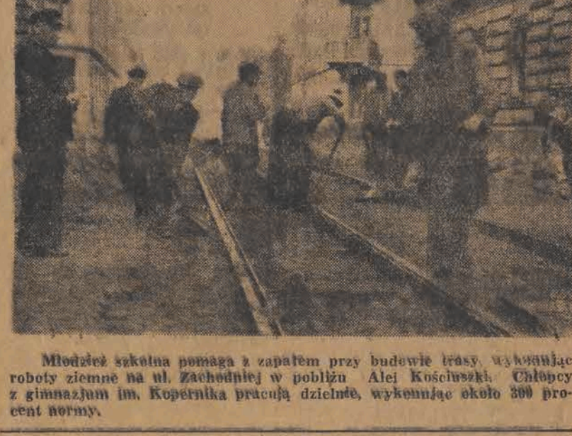
Młodzież szkolna pomaga z zapalem przy budowie trasy. Wykonnając roboty ziemne na ul. Zachodniej w pobliżu Alei Kościuskiej, Chłopcy z gimnazjum im. Kopernika pracują dzielnie, wykonując około 300 procent normy.
