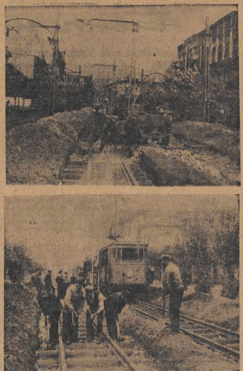
Na całej długości Alei Kościuski wre ożywiona praca. Oto widzimy całe pagórki ziemi, stosy drewnianych podkładów, szyn, obok zaś uwijają się żwawo brygady robotników.
