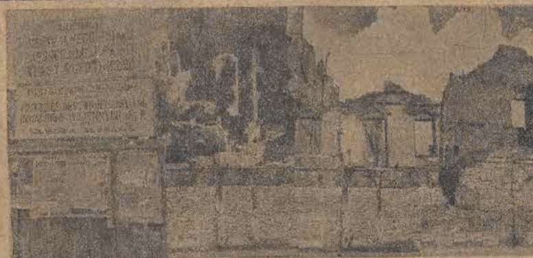
Tak wygląda teren, który przeznaczono pod budowę centralnego domu zjednoczonych partii klasy robotniczej. Przystąpiono już do prac rozbiórkowych i zabezpieczających.
