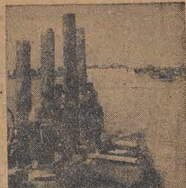
Praca przy budowie mostu Śląsko-Dąbrowskiego wrę. Na zdjęciu umocnienie pali do rusztowania pomocniczego do zakładania konstrukcji żelaznej.
