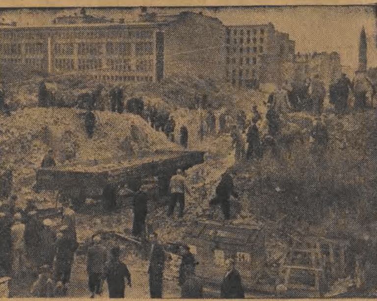
W dniu 1 września rb. Warszawa przystąpiła do budowy nowej wielkiej Trasy N-S, (północ-południe). Na zdjęciu: pierwsze ochotnicze brygady — złożone z pracowników Stołecznych Zakładów Pracy — pomagają przy wykopach pod przyszłą magistralę. (Foto AR)
