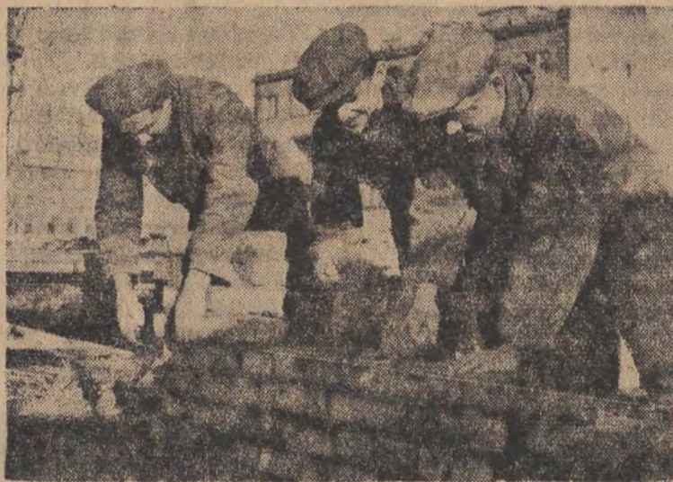
Przy budowie bloku 7-C MDM w Warszawie pracuje grupa młodzieżywa murarzy, którzy rozpoczęli samodzielnie pracę w ubiegłym roku. Młodzi murarze, mimo złych warunków atmosferycznych, wyrobili w pierwszej połowie stycznia 170 procent.
