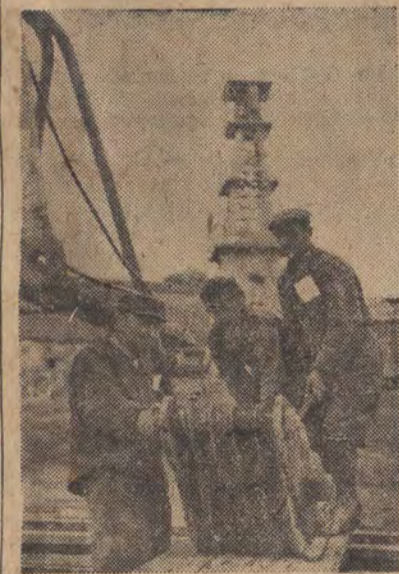
Budowa nowego szybu naftowego w trzecim zespole Kopalnictwa Krośnieńskiego. W głębi stary szyb przeznaczony do rozbiórki.
