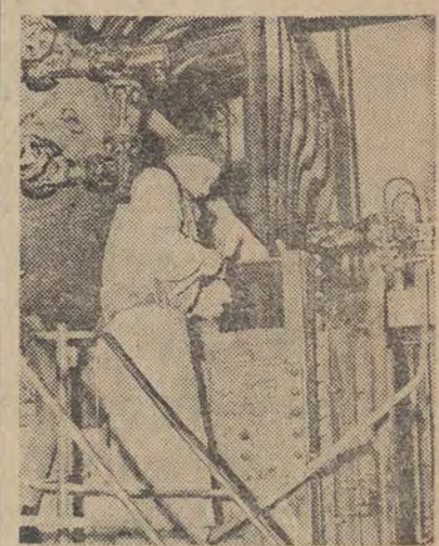
W ramach rozbudowy przemysłu w Ozorkowskich Zakładach Przemysłu Bawełnianego buduje się nową wielką wykończalnię i elektrownię zakładową. Na zdjęciu: Przy obmurzu kotłowni elektrowni zakładowej pracuje producent murar Stanisław Asman. CAF — fot. Dąbrowiecki
