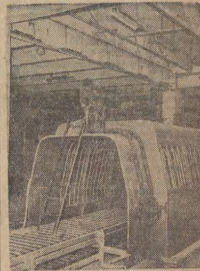
Fragment budowy FSO na Żeraniu. Spawacz Zdzisław Jagiełło przy montażu kabiny deszczowej.
