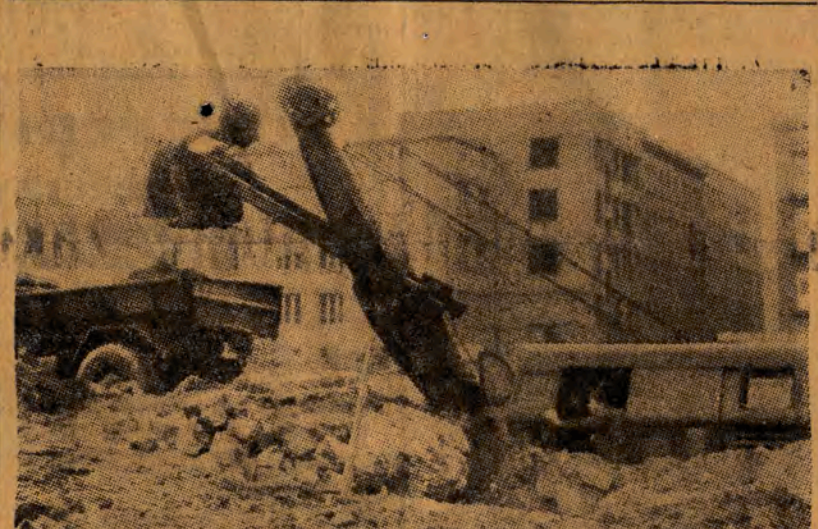
Bałuty — najbardziej zaniedbana w okresie międzywojennym dzielnica Łodzi — obecnie szybko się rozbudowuje. Tam, gdzie niedawno widniały zniszczone, uwalające się rudery, dziś pracują maszyny — koparki. Niedługo stanie tu nowoczesne osiedle robotnicze.
