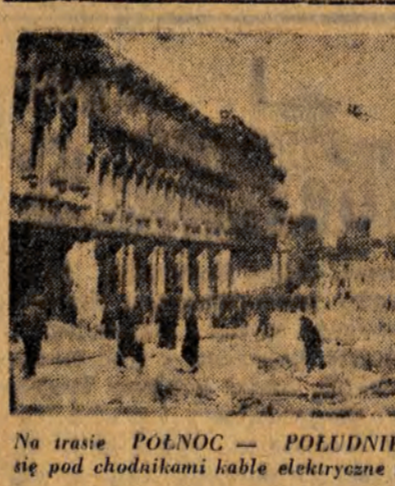
Na trasie POLNOC — POLUDNIE ure wyłożona praca. Obecnie przesuwają się pod chodnikami kable elektryczne i rury gazowe, biegnące do tej pory pod jezdnią.
