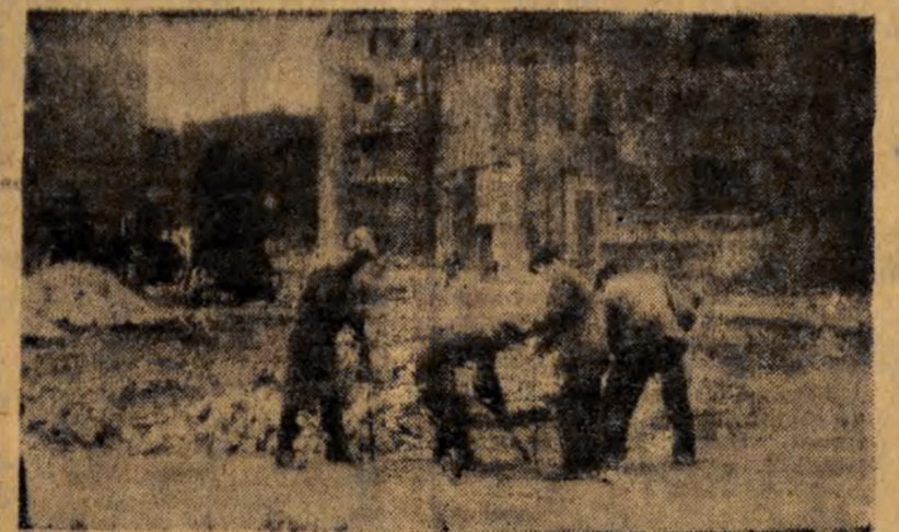
Na nieopowstającej ulicy Ratuzowej prowadzi się obecnie roboty przygotowujące do betonowania nawierzchni.
