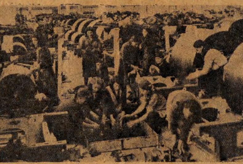
Pod Tiraną w Albanii budowane są dzięki pomocy Związku Radzieckiego wielkie zakłady włókiennicze im. Stalina. Na zleżeniu: montaż maszyn fabrycznych.
