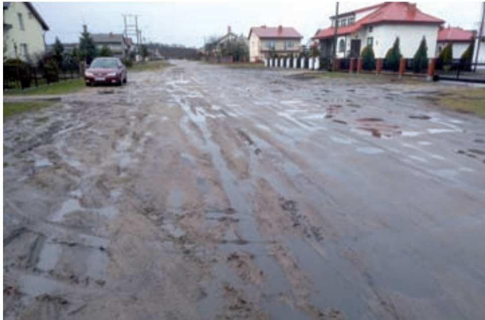
Stan dróg na osiedlu Witosy w Sannikach od lat pozostawia wiele do życzenia.
