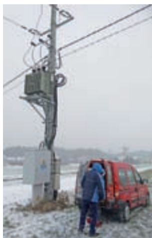
Do wyłączenia prądu doszło poza widoczną na zdjęciu stacją trafo Strzelcew B, na słupie w pobliskim zagajniku. Ktoś wyłączył tam prąd umyślnie.
