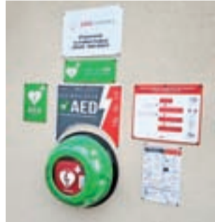
Automacyjny Defibrylator Zewnętrzny (AED) na budynku strażnicy w Pilaszkwie.
