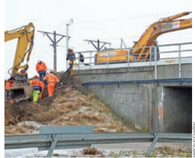
Prace rozpoczęły się od sprawdzenia w terenie którejdy dokładnie przebiegają kable, w tym magistrala światłowodowa.
