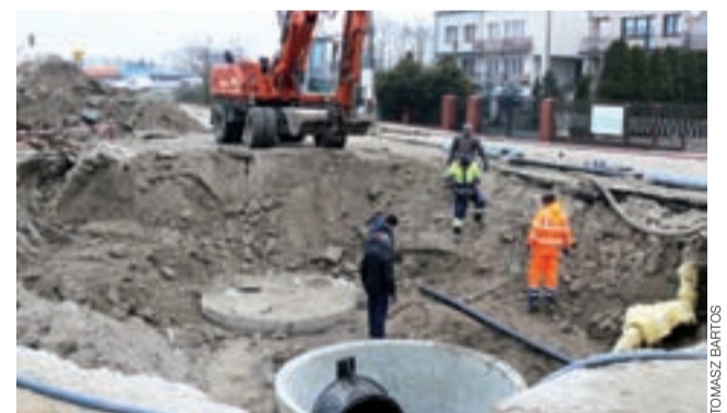
Na zdjęciu widać ogromną dziurę w ziemi powstałą po jej osunięciu i wystające z dna separatory.
