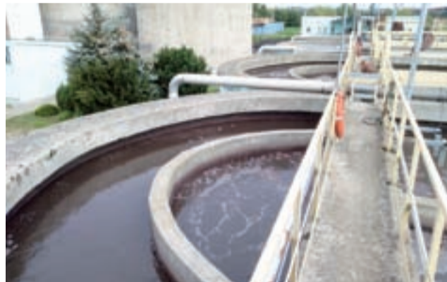
Stojąc na komorach nityfikacji można zobaczyć w oddali duże betonowe zbiorniki, które pełnią rolę komór fermentacji osadów. Gospodarka tymi osadami jest problemem na miejskiej oczyszczalni.
