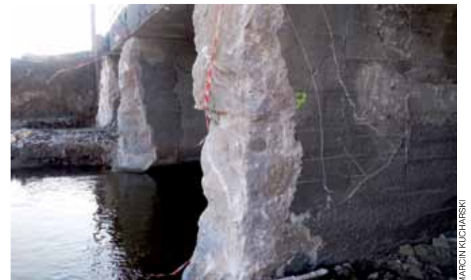
Laik by ocenił, że beton jest „zdrowy”, ale ekspertyzy wykazały, że jego stan był różny w różnych miejscach – m.in. za sprawą wykonywanych nadlewek i połączeń.
