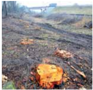
Wycinane były wszystkie drzewa i krzewy w odległości do ok. 15 metrów od skrajnej krawędzi torów.
