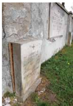
Odstająca płyta nagrobna od muru, z którego odpada tynk – to najgorzej wyglądające miejsce na kwaterze wojennej cmentarza katedralnego.
