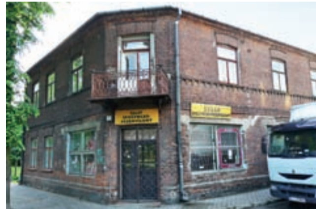
Budynek na rogu ul. Żabiej i Mickiewicza wymaga gruntownego remontu. Sama nieruchomość jest położona w atrakcyjnym miejscu.
