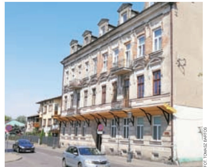
Na kamienicy przy ul. Tkaczew zamontowano pomost zabezpieczający przechodniów przed upadkiem z wysokości elementów elewacji.
