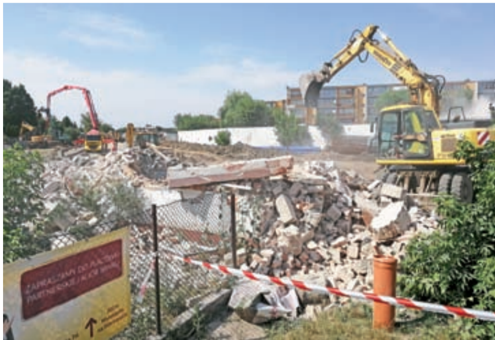
Gruzy zburzonego budynku w miejscu ronda w ul. Bolimowskiej.
