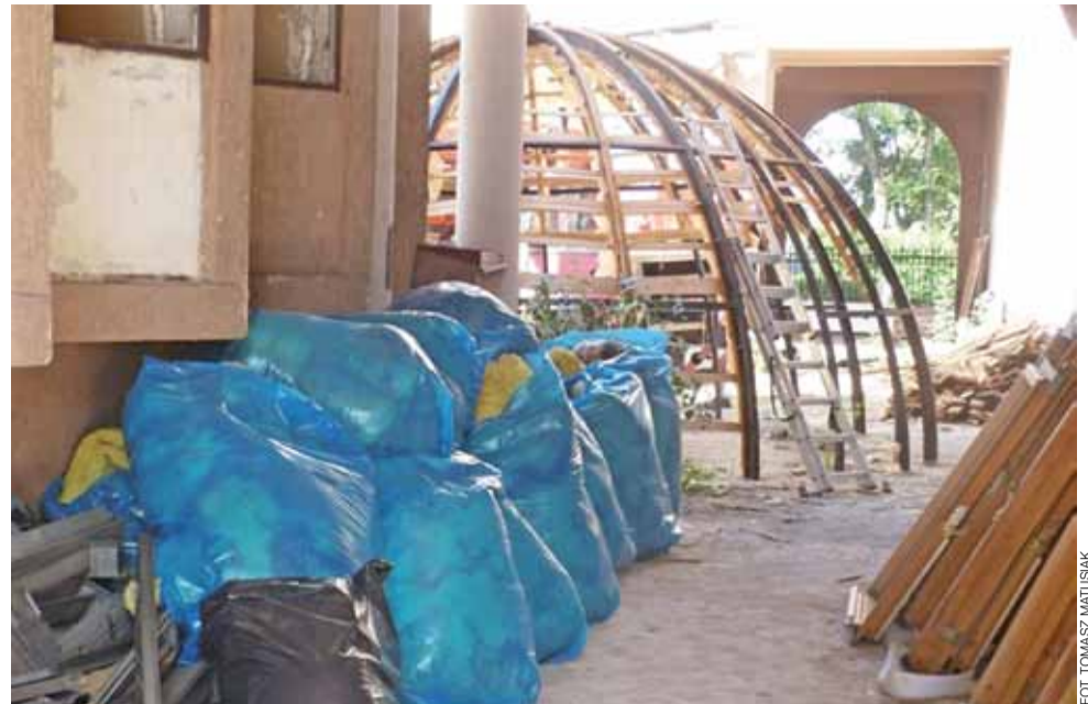
Kopuła, która przez lata była charakterystycznym elementem architektury gmachu, już po zdjęciu z dachu.
