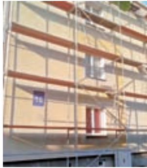
Roboty przy modernizacji elewacji na budynku nr 18 na osiedlu Kostka w Łowiczu.
