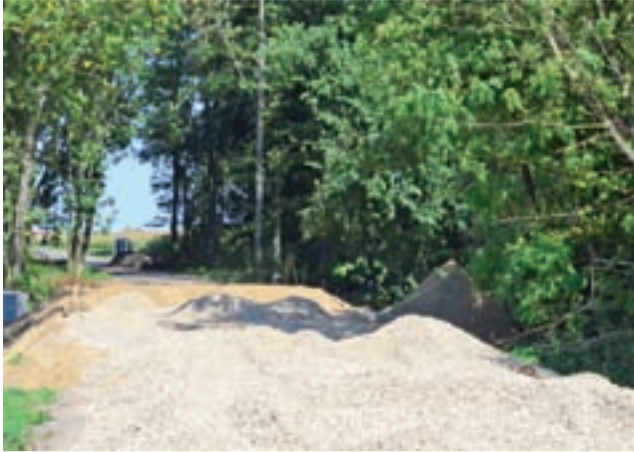
Trwa remont przepustu na rzece Witoni na drodze gminnej, łączącej Kocierzew Południowy z Północnym.
