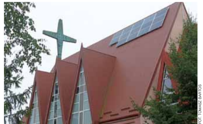
Panele fotowoltaiczne zainstalowane na dachu kościoła w Bobrownikach.
