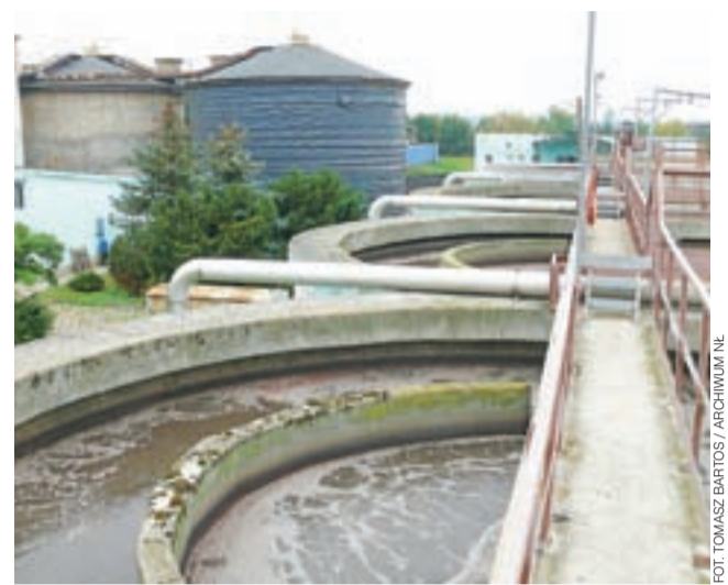
Komory nityfikacji, czyli napowietrzania, z pomalowanymi barierami oraz widocznymi nowymi rurami doprowadzającymi powietrze do dysz zanurzonych w oczyszczanych ściekach.
