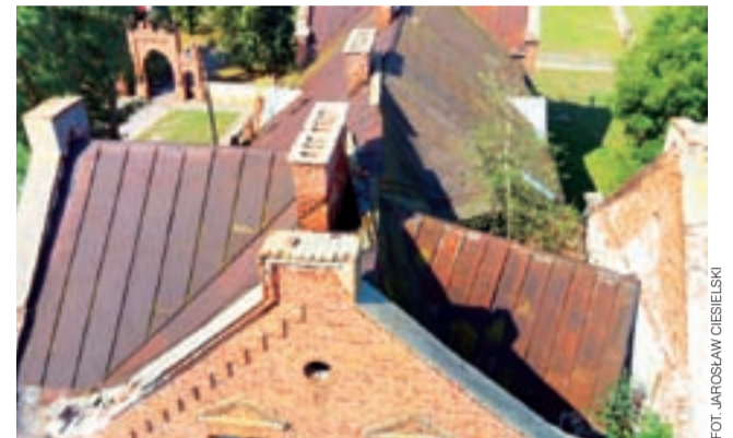
W miejscu gdzie dach się zawalił widać jak wkracza natura – rosną tam małe brzozy.
