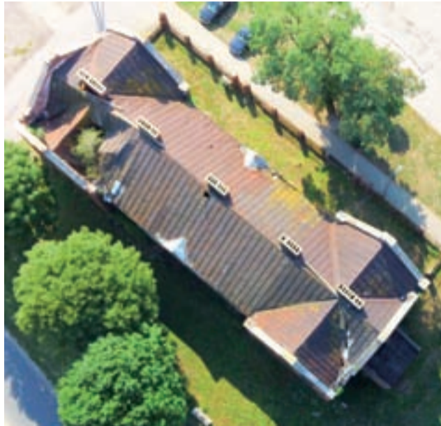
Z góry widać część dachu, która runęła. Właściciel ma obawy, że dalsza destrukcja będzie postępowała coraz szybciej.
