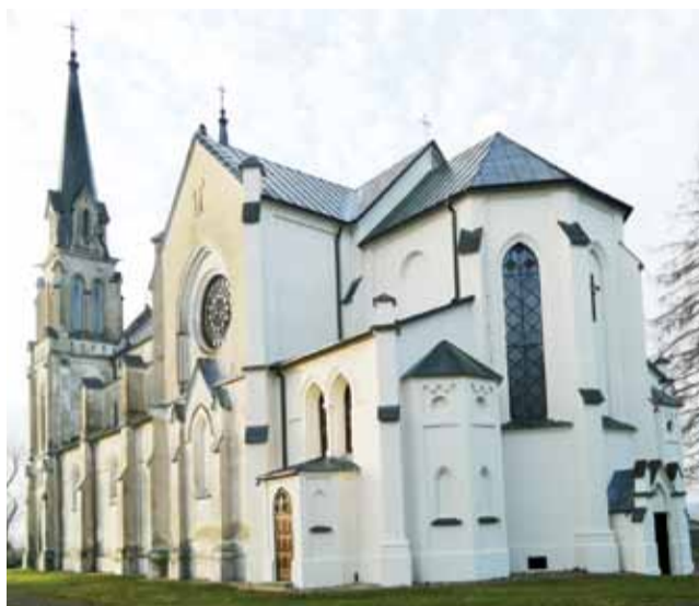
Elewacja kościoła w Nieborowie od strony północnej, gdzie znajduje się prezbiterium. Widać wyraźną różnicę między nowym a starym tynkiem.
