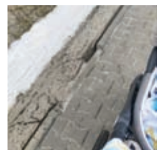
Obsuwający się do rowu krawężnik nowego chodnika na terenie Nieborowa.
