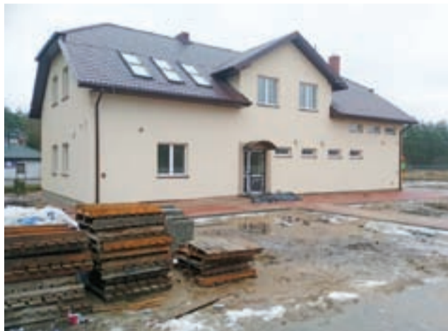
Budynek świetlicy wiejskiej w Dzierżówku na kilka dni przed odbiorem – na zdjęciu widać palety stojące przed budynkiem i niezagospodarowane trawniki.
