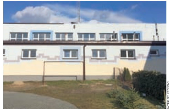
Wichura zerwała część papy termozgrzewalnej z dachu na sali gimnastycznej. Na szczęście nie naruszyła docieplającego styropianu.
