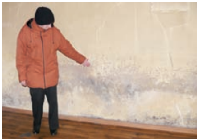
Pani Krystyna Bończak pokazuje zawilgoconą ścianę w domu jej zmarłego syna.
