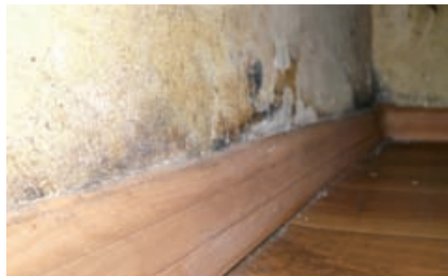
Wilgoć i pleśń na wysokości listwy przypodłogowej ściany działowej.
