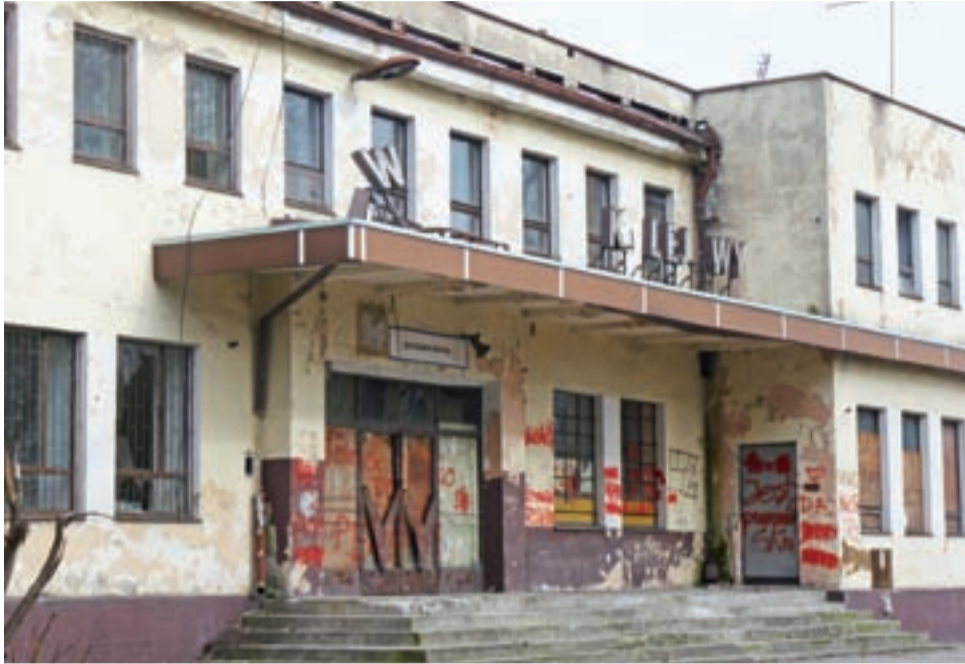
Budynek dworca PKP Żychlin od kilku lat stoi pusty i niszczeje.
