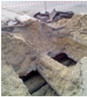
Awaria największej magistrali ciepłej wody zasilającej część osiedla Traugutta.
