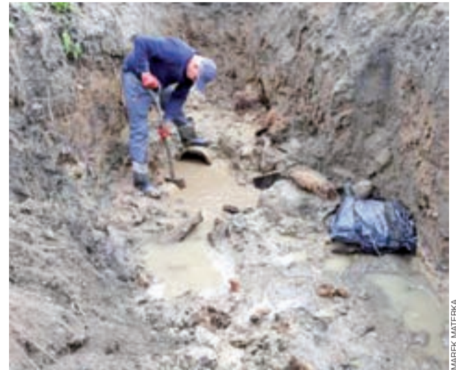
W Dobrzelinie korzenie drzew wrosły w zbieracz o średnicy 35 cm, czopując odpływ wody do rowu melioracyjnego
