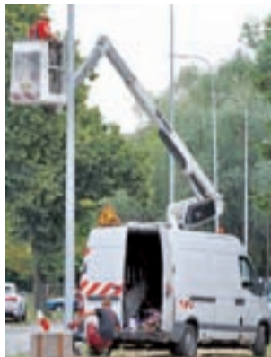
Firma montująca nowe słupy oraz oprawy oświetleniowe na nich jeszcze nie zakończyła robót.
