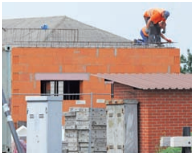
Budynek nastawni w Żychlinie jest rozbudowywany m.in. o dodatkowe pomieszczenie socjalne oraz magazynowe.
