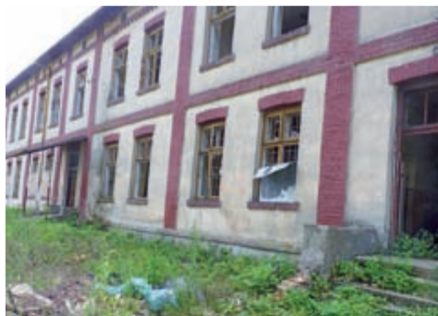
Od ponad 10 lat budynek starej szkoły w Oporowie niszczy się.
