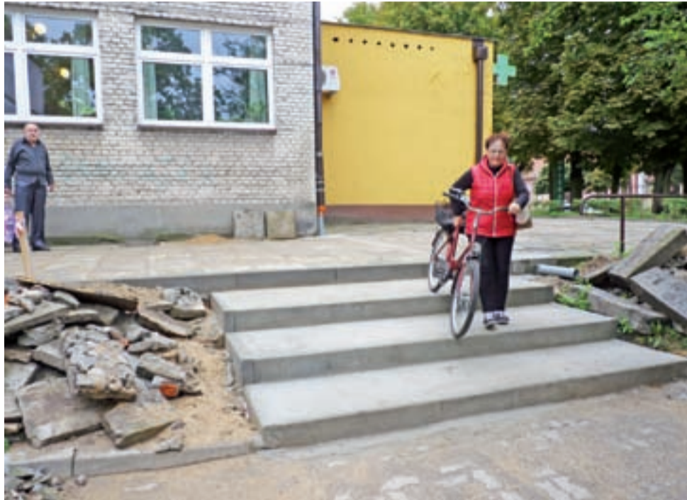
Powoli dobiegają końca prace związane z przebudową schodów prowadzących koło bloku przy ul. Narutowicza nr 71/I i do apteki
