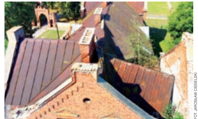
W miejscu gdzie dach się zawalił widać jak wkracza natura – rosną tam małe brzozy.
