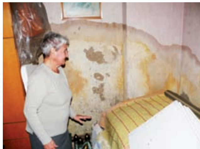
Pani Wanda pokazuje ścianę w pokoju, którego nie używa, do połowy jest ona zawilgocona, czuć przy niej pleśń.
