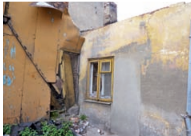
Po rozebraniu części zawalonego budynku, od strony podwórka Jana Pawła II zrobiono sobie „meliń”. Dookoła pełno butelek po alkoholu.
