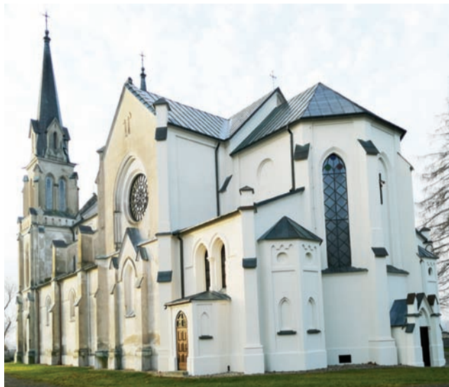
Elewacja kościoła w Nieborowie od strony północnej, gdzie znajduje się prezbiterium. Widać wyraźnie różnicę pomiędzy nowym a starym tynkiem.
