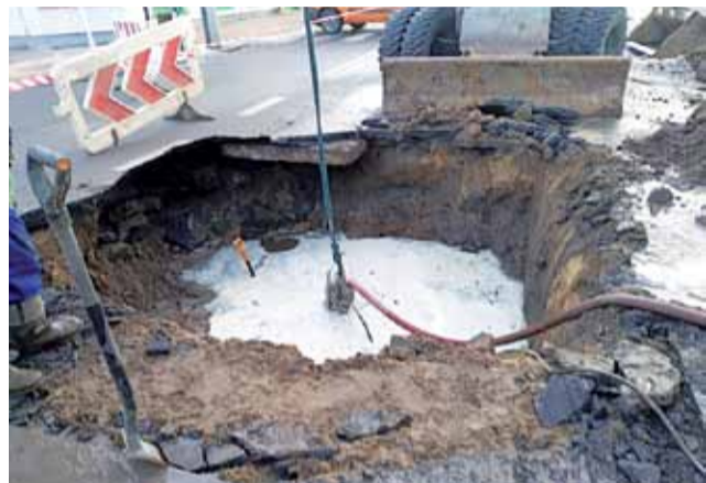
Awaria wodociągowa 8 lutego. Wykop zrobiony w celu usunięcia awarii szybko napełniał się wodą.
