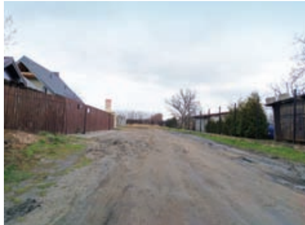
Błotne koleiny i nierówności utrudniają przejście przy ulicy hr. Komorowskiej. Stan na 22 marca.
