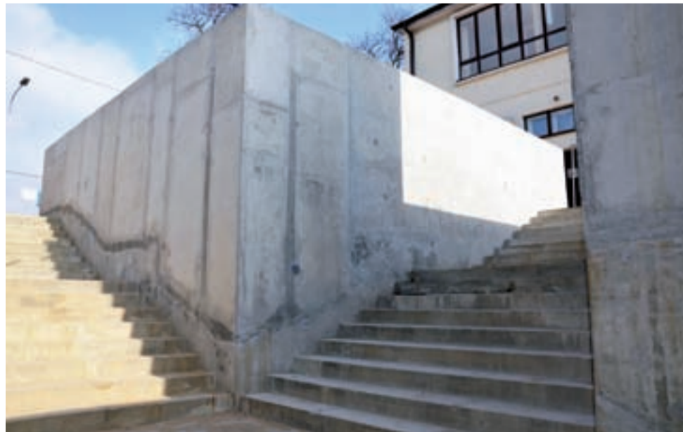
Przejście podziemne pod torami ma być otwarte dopiero po zakończeniu modernizacji peronu 2.
