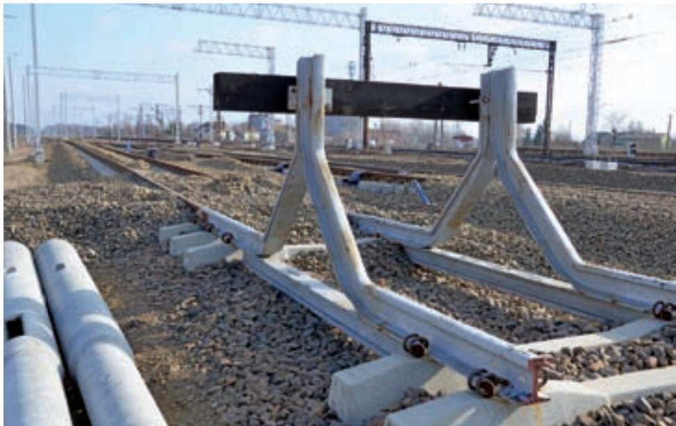
Nieczynny obecnie odcinek torów w rejonie mostu nad rzeką Zwierzyniec i ul. Arkadyjską.
