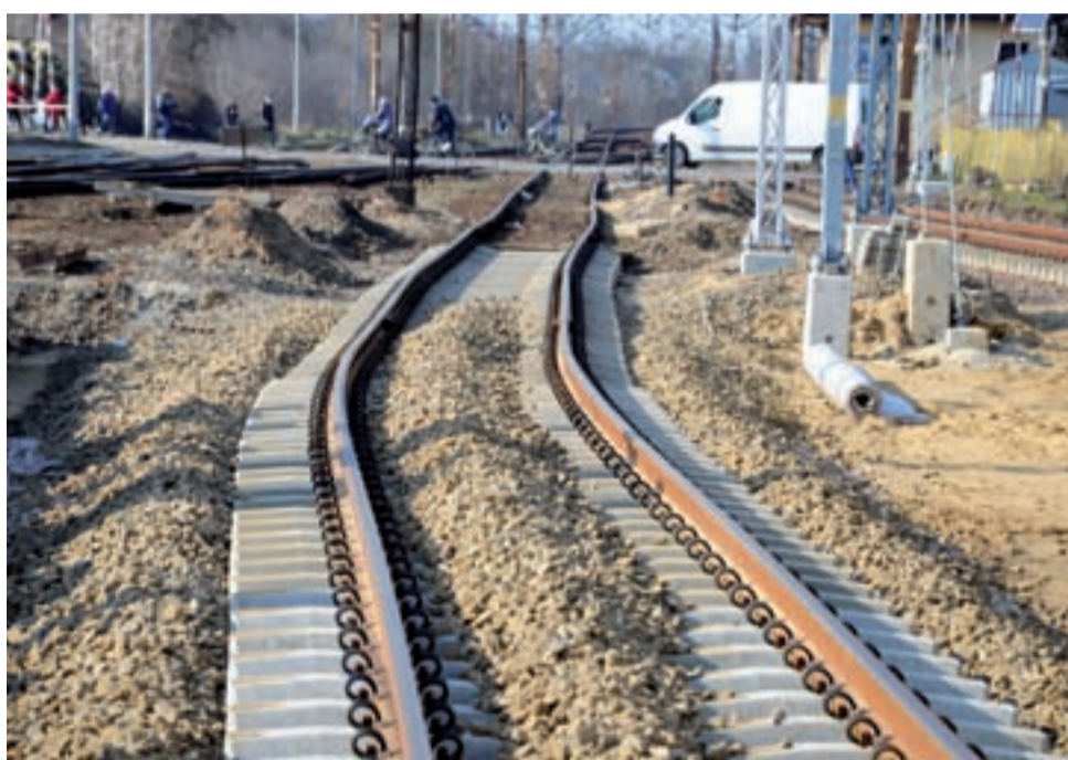
Te tory w przyszłości nie będą takie krzywe. Przed oddaniem odcinka do użytku będą wyrównywane specjalistyczną maszyną, to normalna procedura w tego typu robotach.
