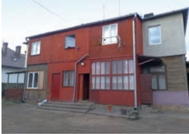
Budynek komunalny na Piaskowej. Zdjęcie archiwalne zostało wykonane w lutym br. podczas interwencji mieszkańców, mającej na celu zwrócenie uwagi na fatalny stan budynku.
