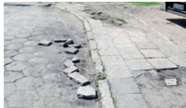
Bezpieczna droga do przedszkola? Raczej nie... Dojazd i chodnik w rejonie Miejskiego Przedszkola nr 2 w Głownie, stan na 24 maja.
