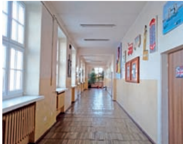
Korytarze na pierwszym i drugim piętrze w SP nr 1 wymagają remontu m.in. z uwagi na nierówny parkiet.
