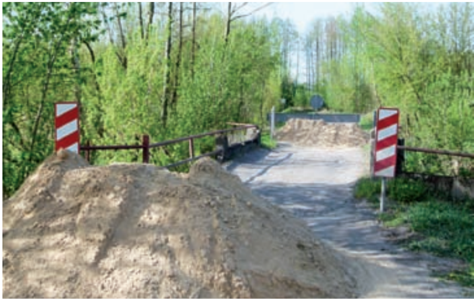
Most w Smolicach czeka na przebudowę.
