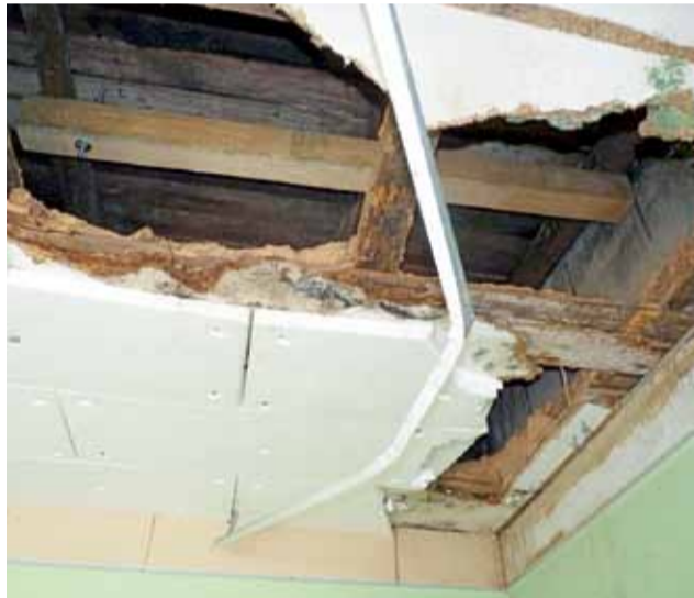
Wyrwa w suficie pomieszczenia biurowego Domu Kultury po akcji strażaków, która miała tu miejsce 19 czerwca.
