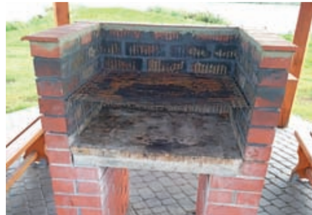
Grill nad zalewem przy ul. Młynarskiej uszkodzony w lipcu. Dziś znów spełnia swoją funkcję.
