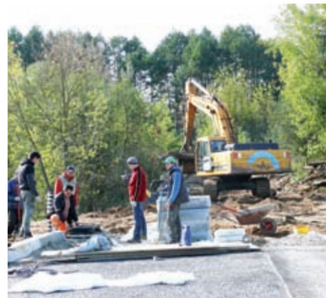
Pod koniec ubiegłego tygodnia na moście trwały prace związane m.in. z układaniem krawężników.
