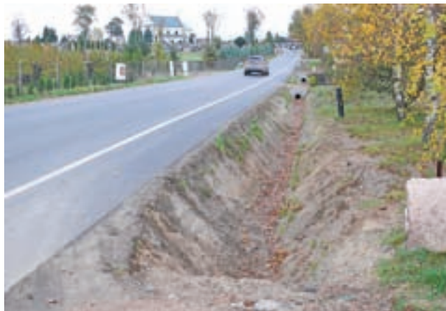
Zmodernizowana droga powiatowa usiana jest zjazdami do prywatnych gospodarstw. Mieszkańcy Dmosina Pierwszego mają uwagi co do ich wykonania.
