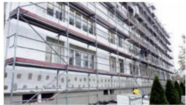
Rozpoczęta latem kompleksowa termomodernizacja bloku planowo ma się zakończyć do połowy listopada.
